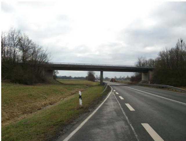
Abbildung 6: Brücke im Zuge der Anschlussstellenrampe Koltzheim – Schweinfurt über die B 286, ASB Nr. 6027 505, in Fahrrichtung Gerolzhofen
