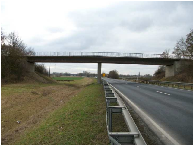
Abbildung 17: Brücke im Zuge der GVS Unterspiesheim – Grettstadt über die B 286, ASB Nr. 6027 504, in Fahrtrichtung Gerolzhofen
